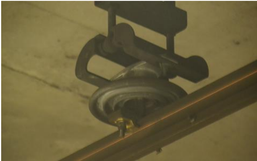
圖 1.7 日本大阪車站直流導電軌系統
