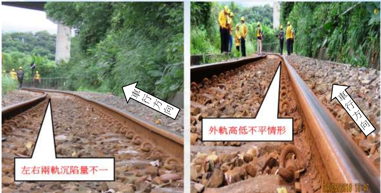
圖 3.2.1-2 軌道水平及方向不良照片
