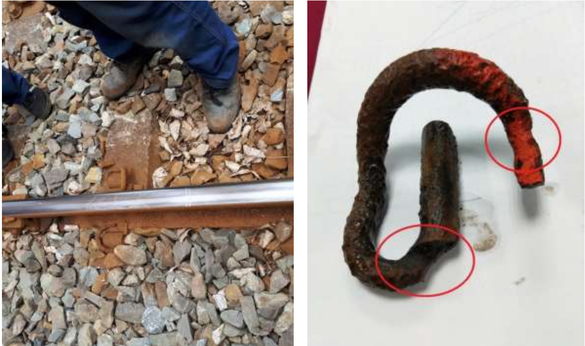
圖 3.2.1-4 鋼軌扣夾鏽蝕照片
