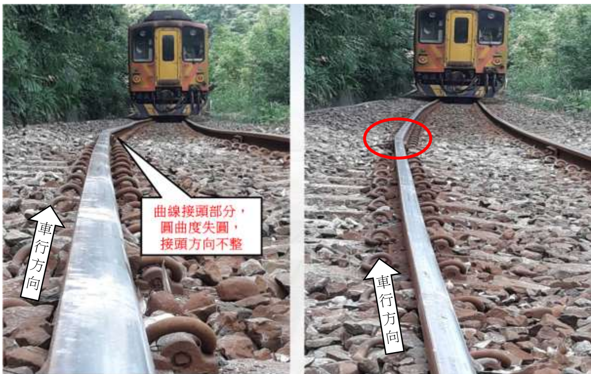
圖 3.2.1-3 鋼軌曲線接頭圓曲度失圓照片
